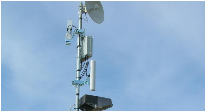
Una delle postazioni che diffondono il segnale web a Verrua Savoia
